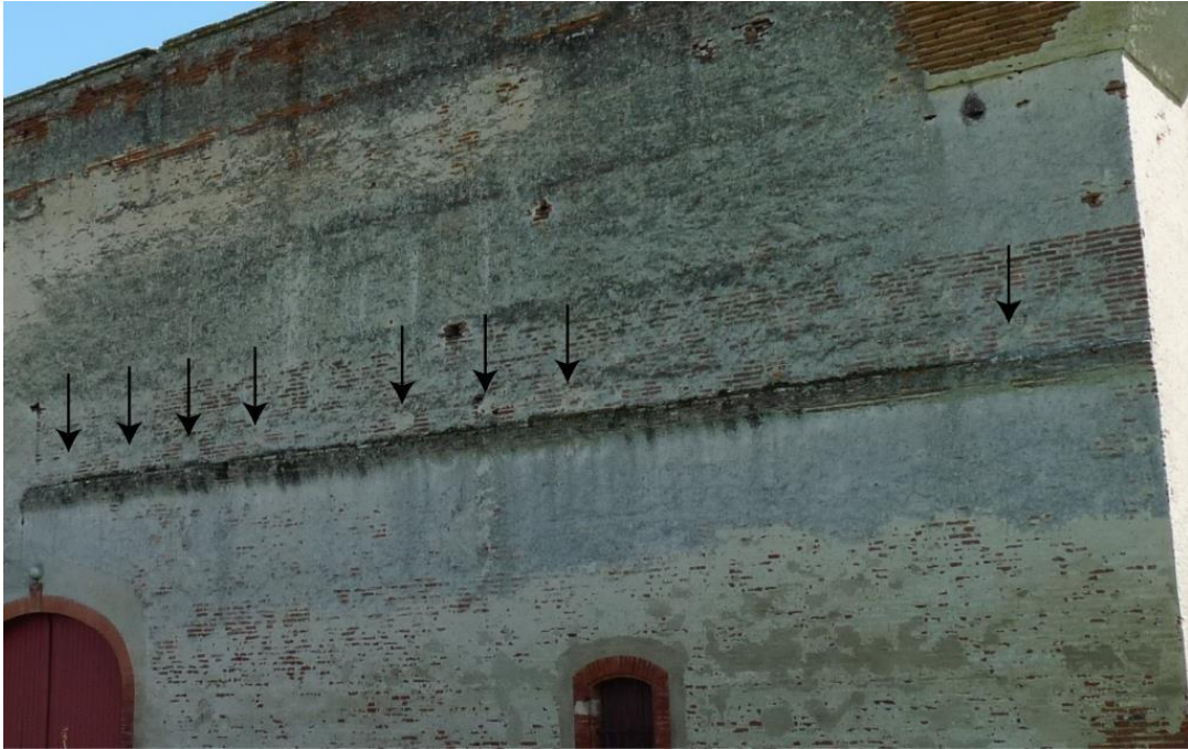
Figure 89 : Repérage d'exutoires bouchés au-dessus de la corniche moulurée de la façade nord, ancien mur gouttereau nord du bâtiment B détruit.
