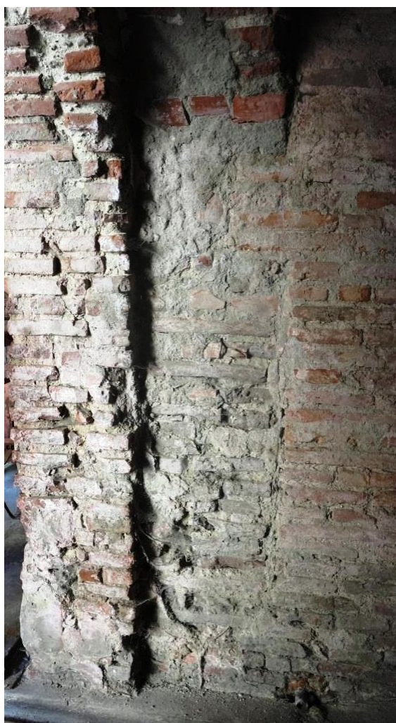
Figure 64 : Traces de bûchement sur le piédroit sud de la porte 1405.
