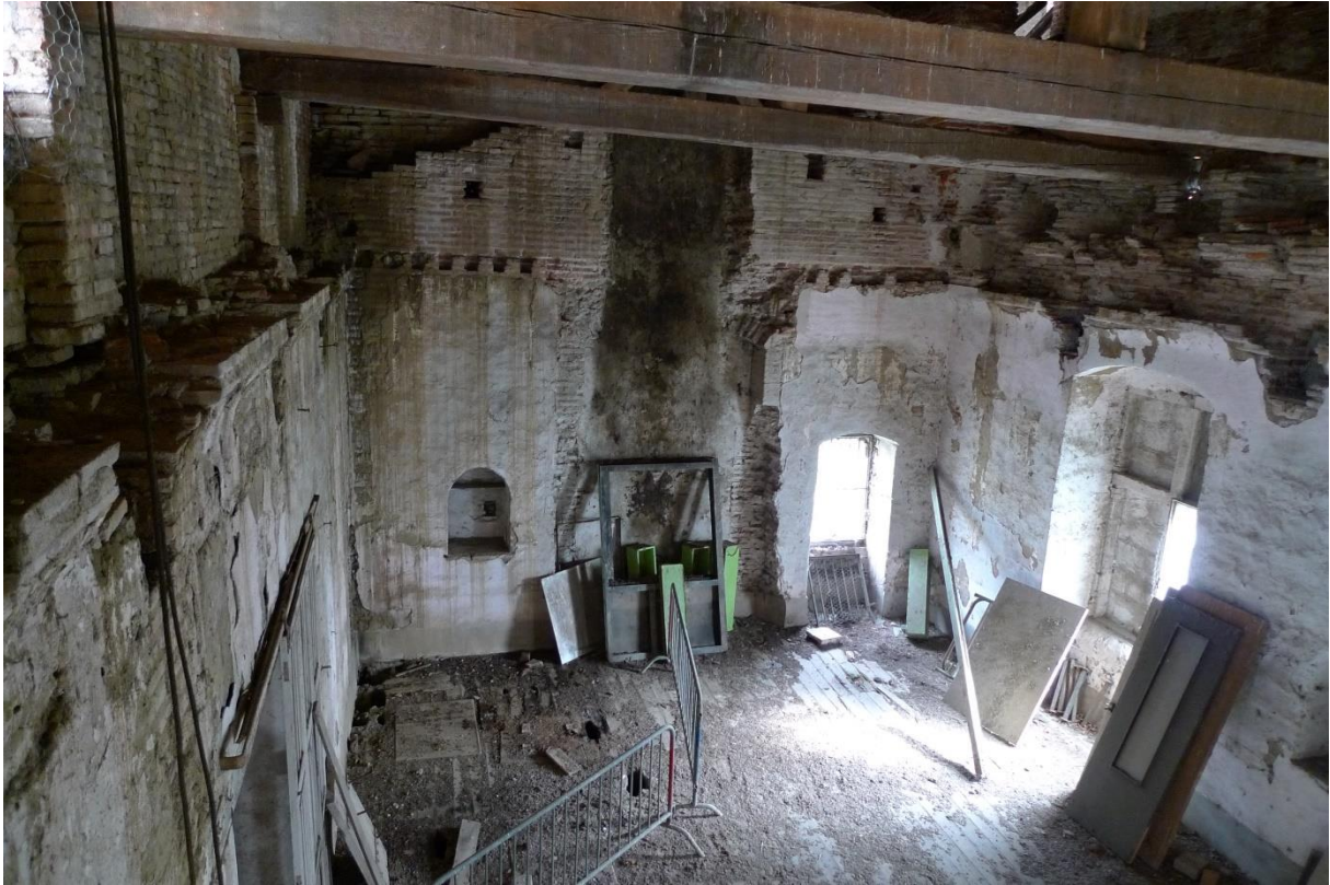
Figure 91 : Traces d'une ancienne cheminée (2306) aménagée dans l'embrasure d'une ancienne fenêtre géminée, sur le mur est du corps de bâtiment A2 (premier étage).
