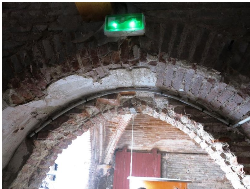
Figure 63 : Traces de bûchement sur l'arrière-voussure de la porte 1405.
