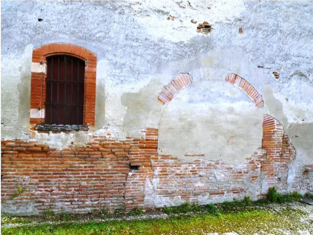
Figure 102 : Jour 1205 et portail bouché, percés dans la façade nord au XVII e siècle.
