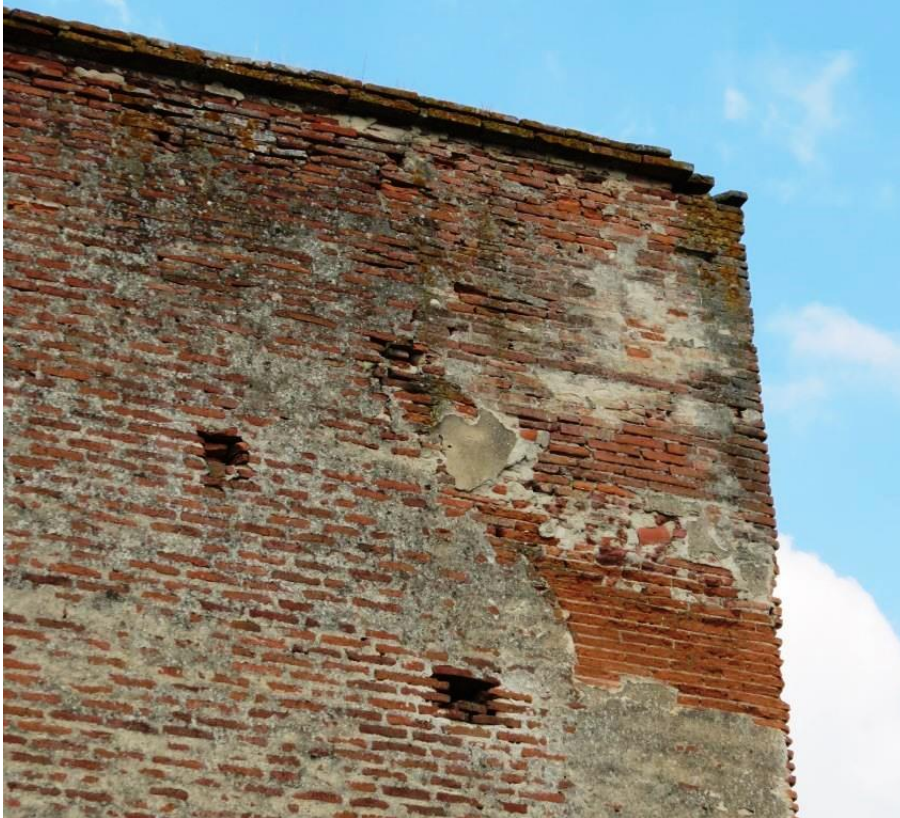
Figure 47 : Négatif d'une échauguette (43) détruite dans l'angle sud-ouest, datée du XVII e siècle, dont le bouchage est couvert par le larmier du XIX e siècle.
