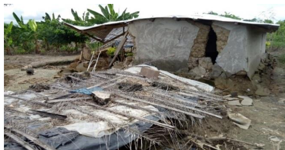
Photo 4 : maison détruite par la montée des eaux au quartier Solibra
