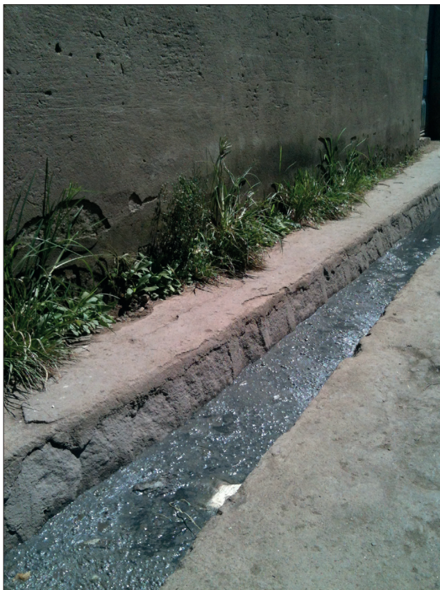
Figure 5 – Photographie de canal à ciel ouvert servant de réceptacle à ordures à Mandroganbato I
