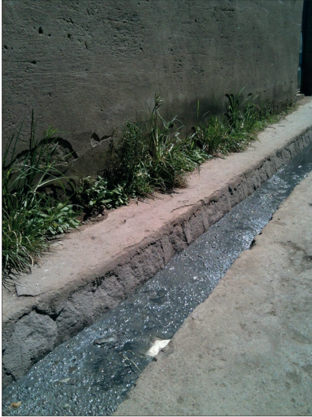
Figure 5 – Photographie de canal à ciel ouvert servant de réceptacle à ordures à Mandroganbato I
