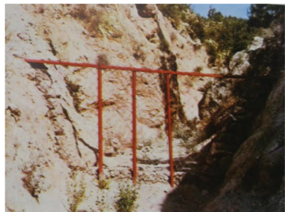
Figure 4: Seuil en grillage avec piquets
