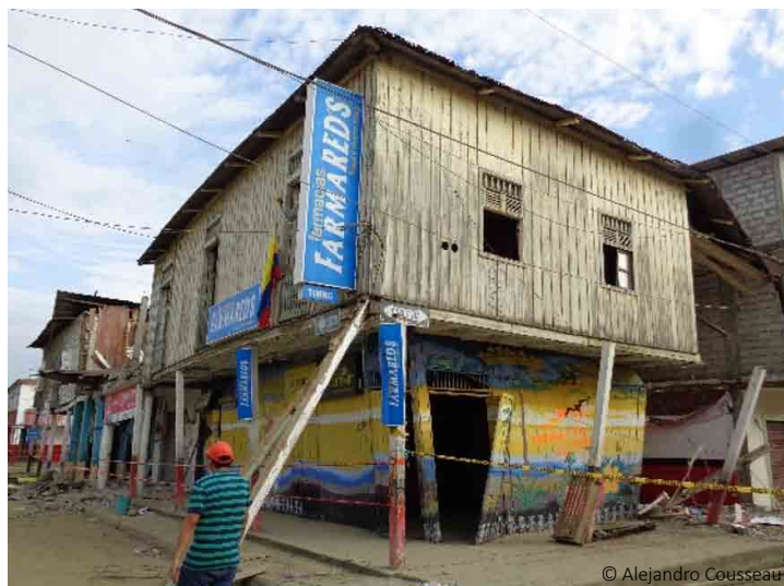
Vivienda urbana vernácula de madera en el municipio de Jama, dañada tras terremoto pero no habiendo colapsado.
