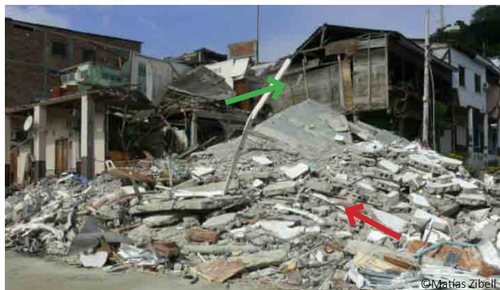
Vivienda vernácula en pie al lado de inmueble colapsado de bloques de cemento (Bahía de Caráquez).
