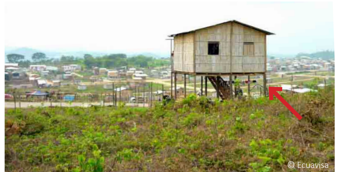
Ausencia de arriostramientos en la planta baja.
