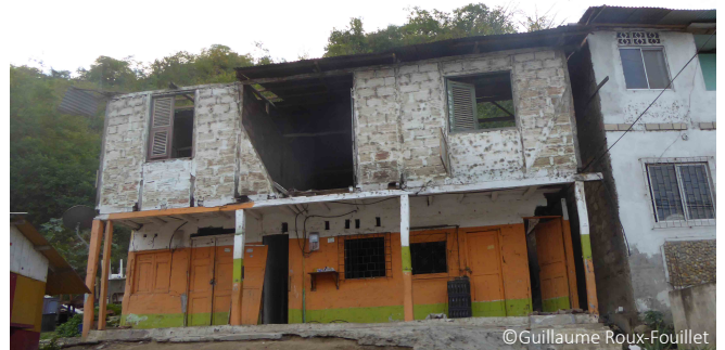
Problemas de estabilidad frente al sismo de los muros de albañilería sustitutos de la caña picada en viviendas de estructura de madera.
