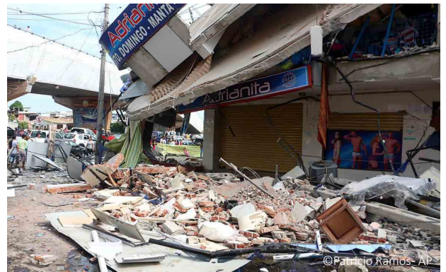
Inmueble colapsado tras terremoto en Manta.
