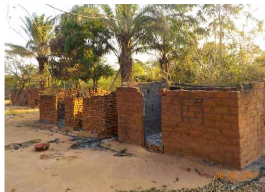
Maisons ayant perdu la tôle de couverture probablement à cause d'une situation de conflit près de Kalemie, Tanganyika. Les tôles sont souvent volées ou vendues en cas de besoin. © A. Mbumb Kazemb
