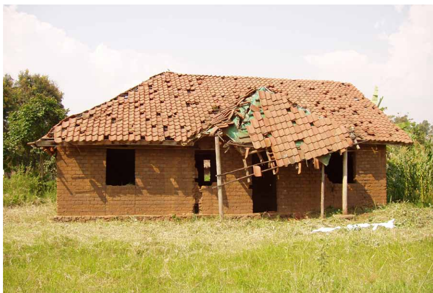
Matériau de couverture trop lourd pour une structure de charpente sous-dimensionnée. Manque d'entretien de la toiture. Près de Rutshuru, Nord-Kivu. © O. Moles - CRAterre
