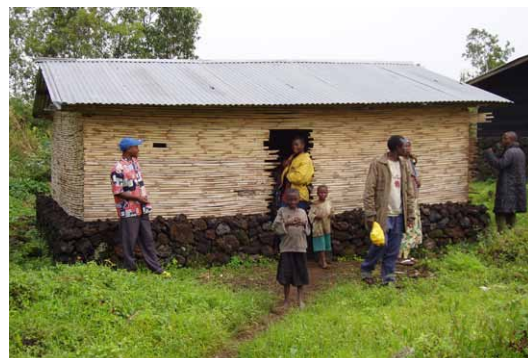
Le soubassement en pierre de cette maison en construction dans une zone montagneuse du Nord-Kivu garantit une durabilité accrue grâce à la protection contre l'humidité du sol et contre les effets des inondations le cas échéant. © O. Moles- CRAterre
