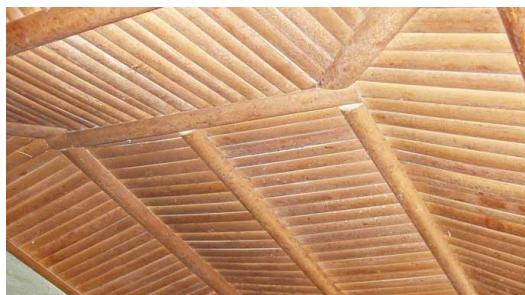
Faux-plafond de 20 ans construit en tiges de raphia près de Kabalo, Tanganyika. © O. Moles- CRATERRE
