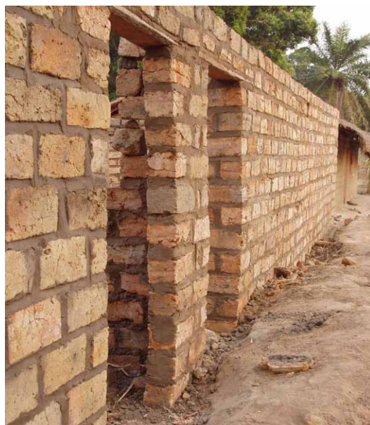
Par souci d'économie les murs en briques cuites sont très fins : en cas de séisme les murs s'effondrent. De même, les linteaux qui assurent la répartition des charges au niveau des baies sont sous-dimensionnés (trop fins). © CRAterre
