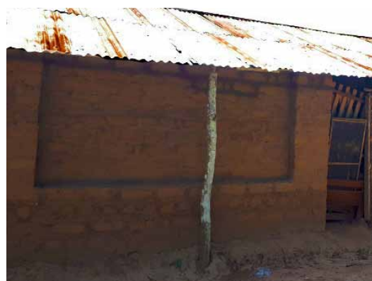
Cette toiture est attachée au sol par des poteaux en bois qui empêchent son arrachement par le vent. © NRC
