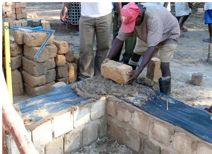
Barrière capillaire entre le soubassement en blocs de sable-ciment et la maçonnerie en adobes. © CRAterre
