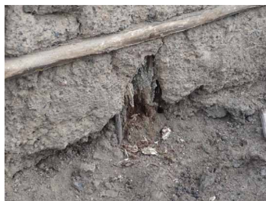
Le contact du bois avec l'humidité du terrain crée des problèmes de pourriture du bois. Maison près de Goma, Nord-Kivu. © G. Paccoud- CRAterre
