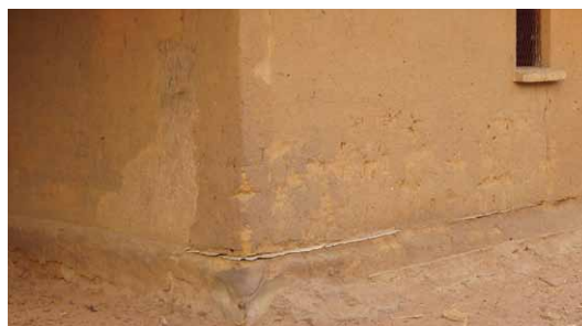
Maison en adobe avec barrière étanche pour éviter les remontées d'humidité du sol. Près de Kabalo, Tanganyika. © CRAterre
