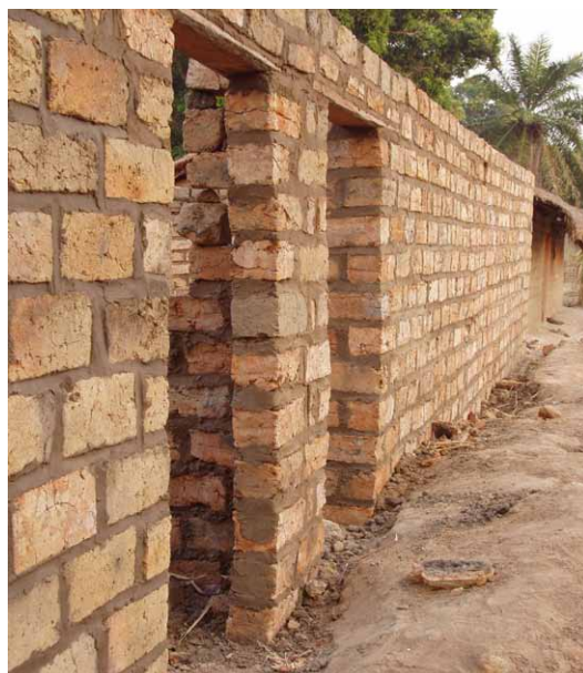
Par souci d'économie les murs en briques cuites sont très fins : en cas de séisme les murs s'effondrent. De même, les linteaux qui assurent la répartition des charges au niveau des baies sont sous-dimensionnés (trop fins). © CRAterre
