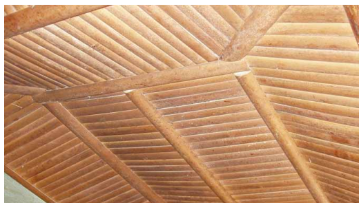
Faux-plafond de 20 ans construit en tiges de raphia près de Kabalo, Tanganyika. © O. Moles- CRAterre
