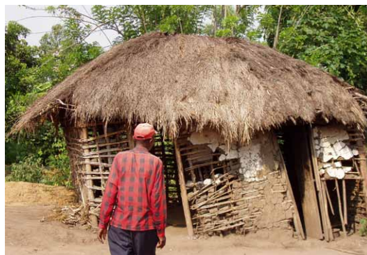
Manque de stabilité par absence de contreventements dans l'ossature porteuse en bois. Les poteaux en bois sont directement plantés sur le sol, ce qui favorise le pourrissement de leur base en contact avec l'humidité. Rutshuru, Nord-Kivu. © O. Moles - CRAterre
