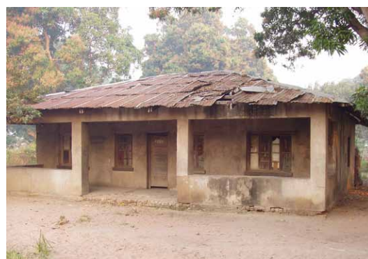
Toiture en tôle très détériorée en raison d'un ancrage insuffisant pour la résistance aux vents et d'un mauvais entretien. Si les éléments de couvertures arrachés ou détériorés ne sont pas remplacés, la charpente est rapidement attaquée. © CRAterre
