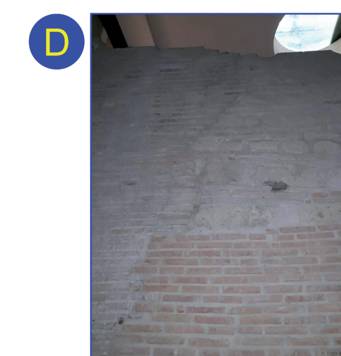
Rifacimento della parte alta della muratura con opera mista al di sopra di un intervento moderno in laterizi
