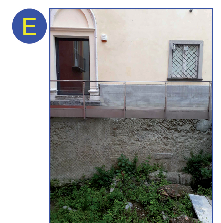
Sarcitura di lesione in blocchetti di tufo all'interno della muratura in opera reticolata
