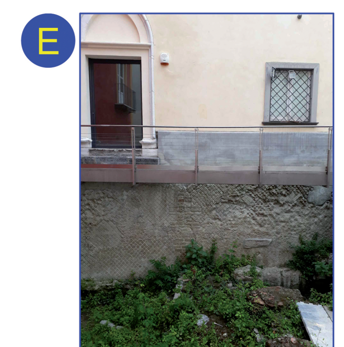
Sarcitura di lesione in blocchetti di tufo all'interno della muratura in opera reticolata
