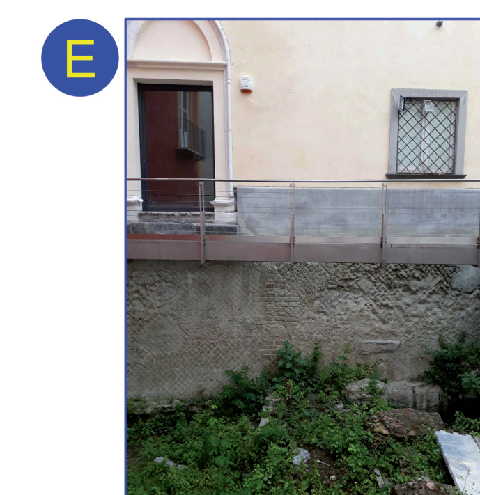
Sarcitura di lesione in blocchetti di tufo all'interno della muratura in opera reticolata
