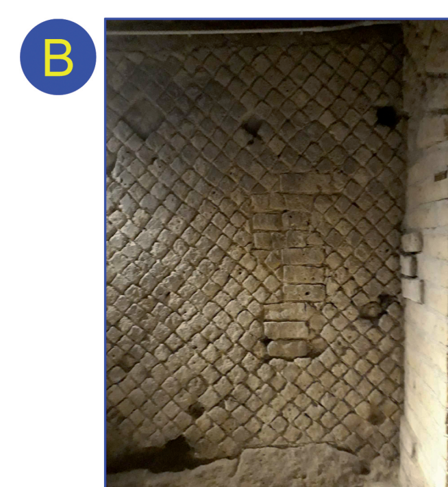
Sarcitura di una lesione in blocchetti di tufo all'interno della muratura in opera reticolata
