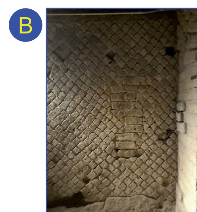
Sarcitura di una lesione in blocchetti di tufo all'interno della muratura in opera reticolata
