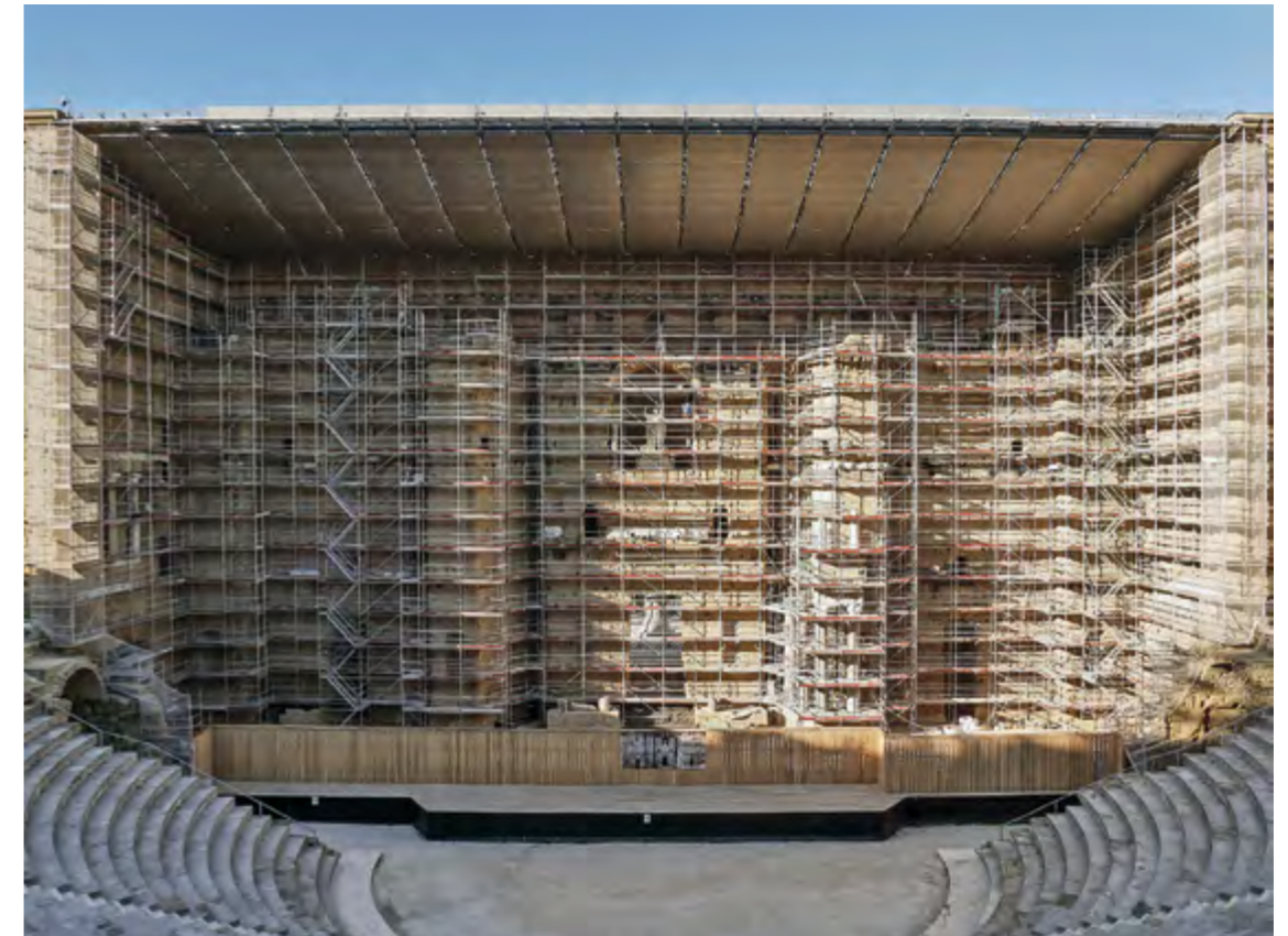
Fig. 173 – ORANGE, PCR « Architecture, technique et décor du théâtre antique ». Le front de scène échafaudé en janvier 2019 (cliché S. Dubourg).
