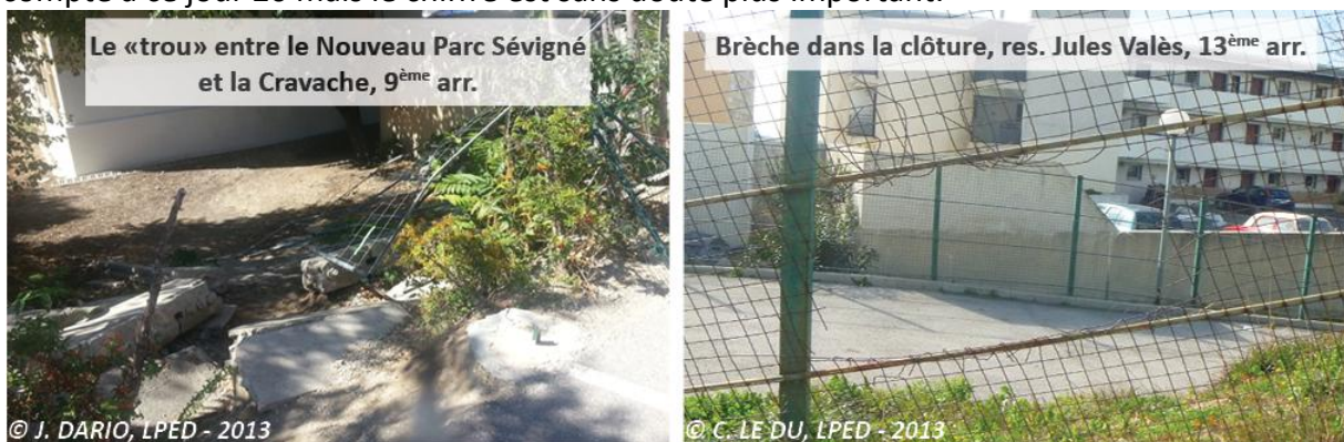
Photos/figure 5: brèches dans l'enceinte des résidences fermées
