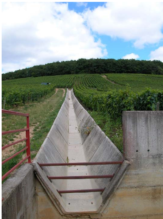
Figure 4. Ravine bétonnée aménagée en collecteur des eaux chargées en sédiments (Corton, août 2006)
