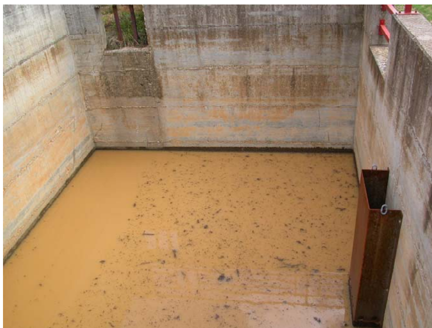
Figure 5. Bac bétonné de récupération et de décantation des eaux chargées en sédiments, aménagé à mi-versant (Corton, août 2006)
