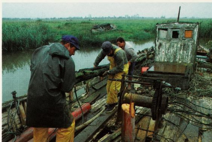
88. Démolition d'une chaloupe à truble au port de Carrie, estuaire de la Loire (44) par MM. Callard, Bossard et Garnier, juin 1988.
