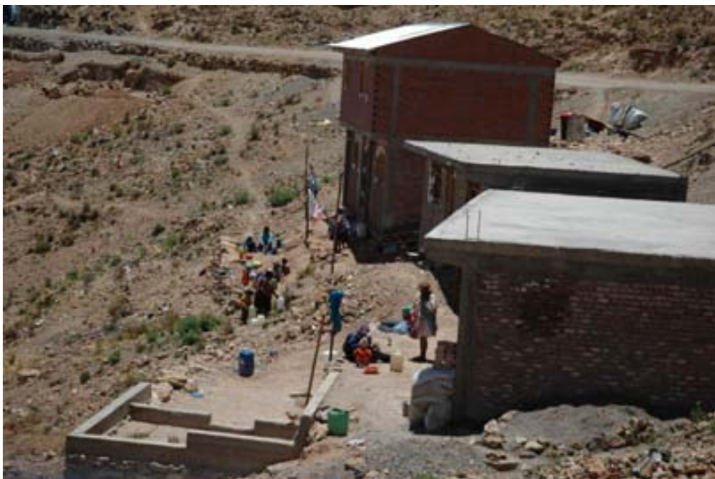
En San José, y en muchas de las laderas de la ciudad (San Miguel, Socavón, etc.) las casas se construyen directamente sobre los desmontes, a veces antiguos, a veces muy recientes. Las condiciones de vida son difíciles por la falta de servicios básicos (agua, alcantarillado a veces luz) y por la infiltración de aguas de drenaje ácido.
