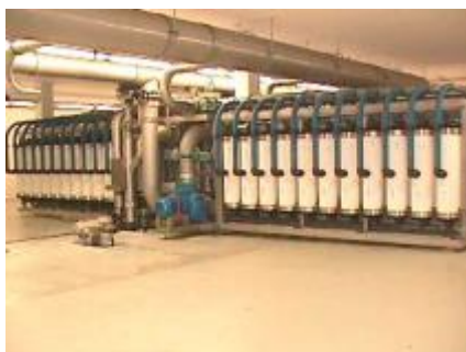
Figure 3.5 : Usine de potabilisation d'eau utilisant des membranes d'ultrafiltration
