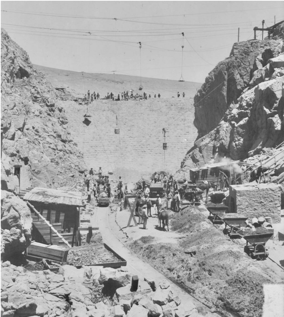
Figura 5: Faenas de la construcción del Tranque Sloman, fotografía de Hans Steffen, Salpeterabbau bei Tocopilla. Archivo: Ibero-Amerikanisches Institut, Berlín. Gentiliza. B. Ballester.
