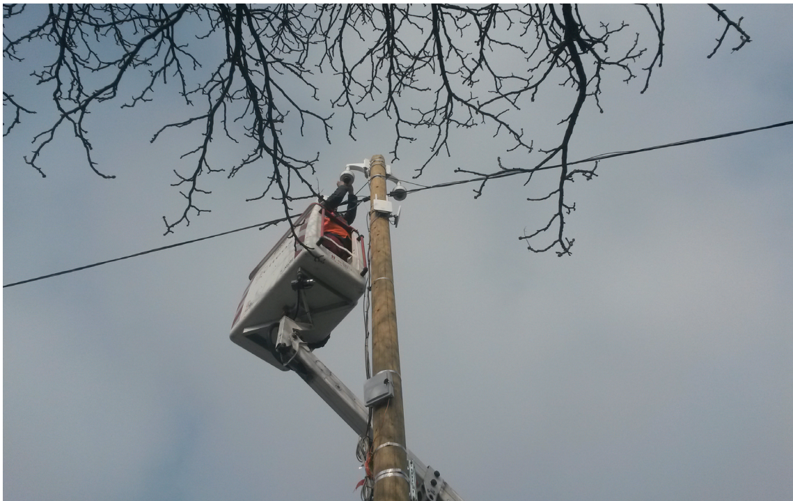
Fig.1 - Installation du « démonstrateur urbain » Place de la Nation, Paris le 18 mars 2016 (© auteur).
