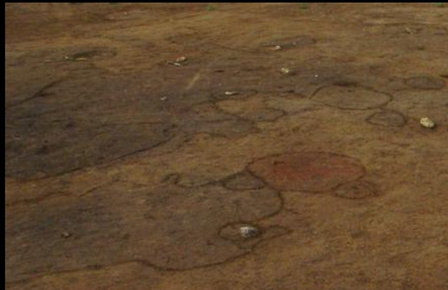
Διάγνωση μετά την αφαίρεση του επιφανειακού
