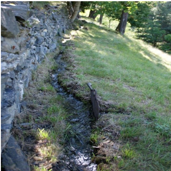
Figure 27 : Canal de la Vigne, mur de soutènement et tourne, Hauteville-Gondon 5/7/12 (cliché B. Meilleur)
