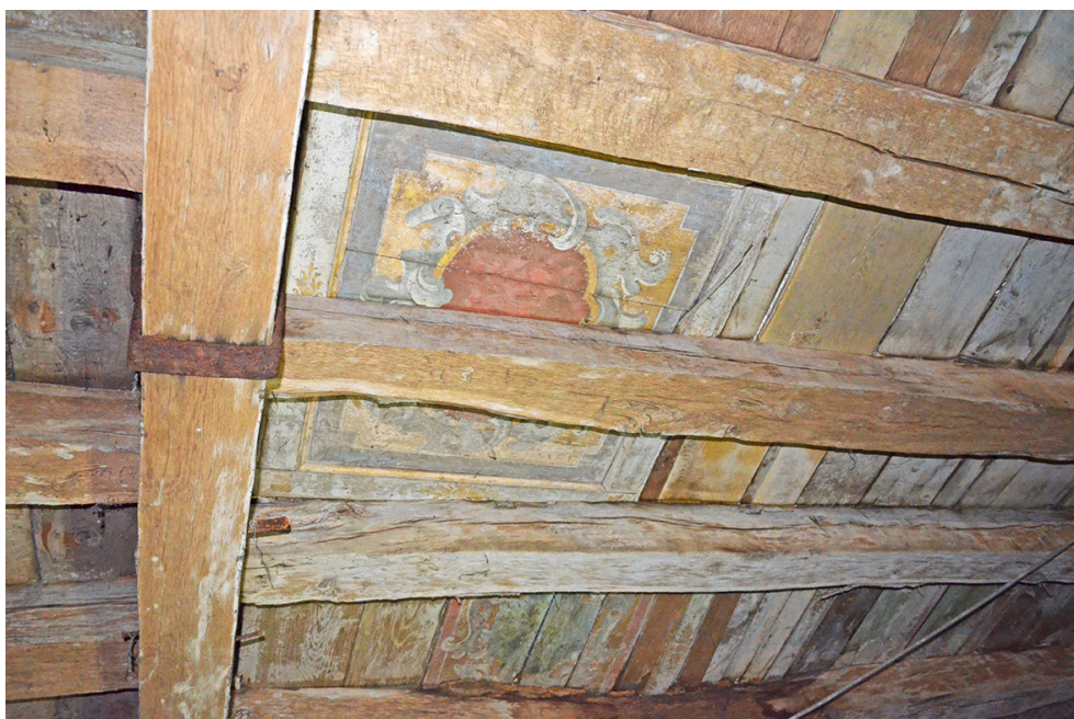
Fig. 17 – Vue d'un panneau de bois peint présentant un motif héraldique réutilisé en tant que plancher dans le grenier du Logis de Broyes
