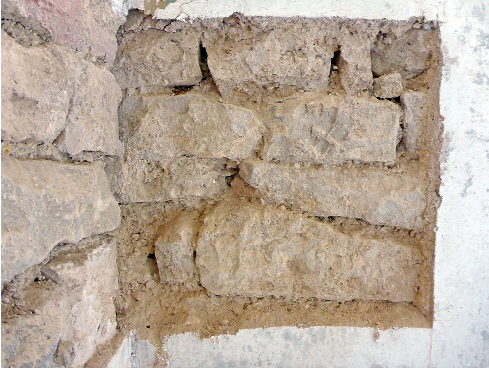
Fig. 6a – Vue de la maçonnerie UC 2006 dans le sondage 7 de la pièce 2
