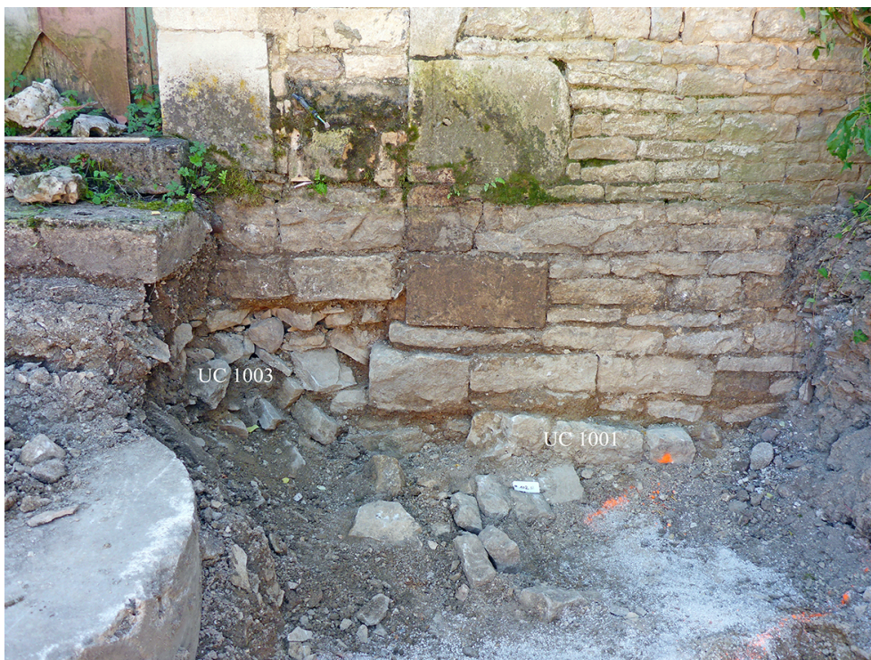
Fig. 10 – Vue de la maçonnerie 1001 et de la zone de vide comblée par le bouchage UC 1003
