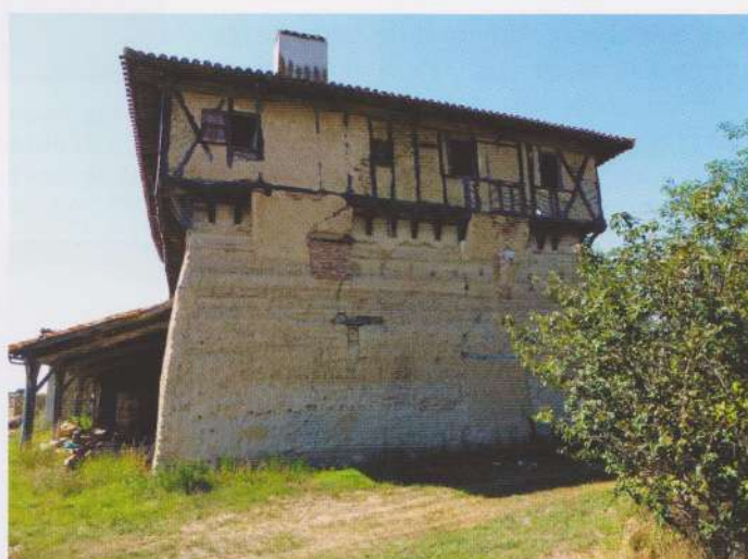
Fig. 32. Juilles. Grange. Façade est. L'angle sud-est a fait l'objet d'une réparation qui a accentué le fruit du mur (photo M.-T. Tinet- Lassure)
