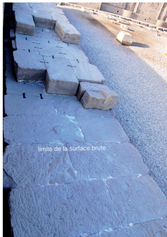
Fig. 26. Dendara, temple d'Hathor, côté est de la cour, section du mur péribole arrêtée en cours de chantier et illustrant la chaîne opératoire de la maçonnerie. Limite de préparation du lit d'attente et de la surface brute.
