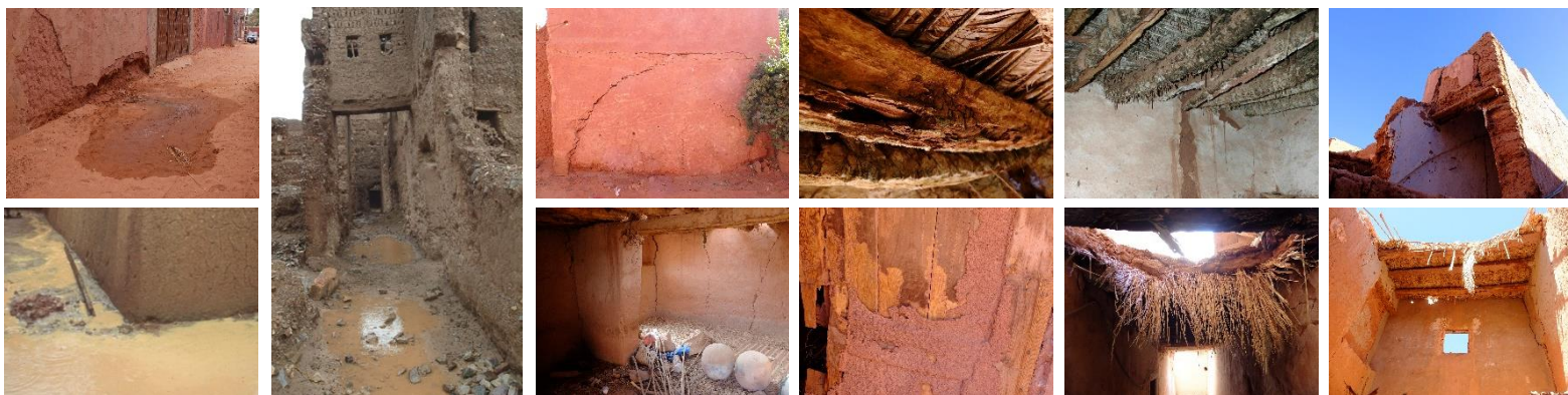
tassement et fissuration de murs reposant sur un sol humide
