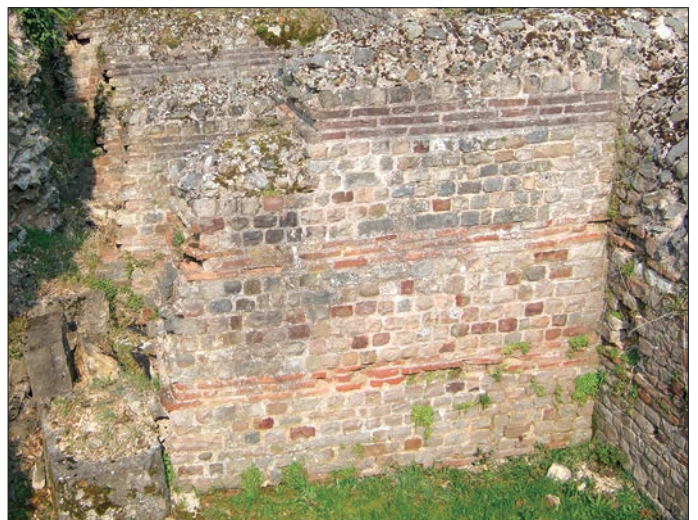
Fig. 19 – Mur de refend BB01 (fait architectural 68 ; technique F) des loges inférieures soutenant la terrasse de l'espace basilical (cliché : C. Louvion).
