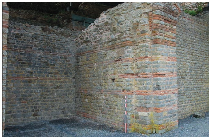
Fig. 6 – Le mur de fond et le mur de latéral EXS4-S/O (fait architectural 16 ; technique C) et le demi-pilier PSE14 (fait architectural 20 ; technique A) de l'exèdre EXN3 de la branche septentrionale du cryptoportique (cliché : C. Louvion).
