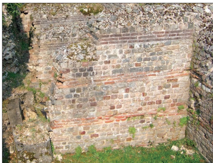
Fig. 19 – Mur de refend BB01 (fait architectural 68 ; technique F) des loges inférieures soutenant la terrasse de l'espace basilical (cliché : C. Louvion).
