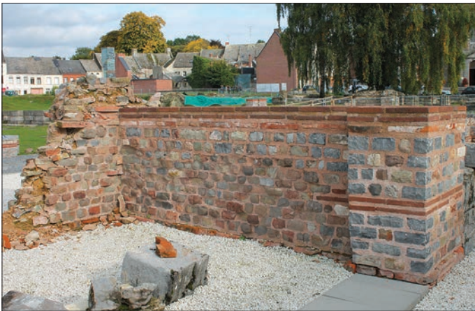
Fig. 15 – Mur de refend RB4 (fait architectural 45 ; technique H), son extrémité (fait architectural 46 ; technique J) et le mur de fond MPT05 (fait architectural 41 ; technique H) dans la boutique extérieure BO05 de l'esplanade (cliché : C. Louvion).
