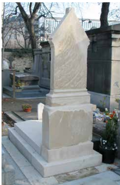
Sépulture dont la pierre est dégradée par nettoyage inadapté, à base de produits chlorés projetés à forte pression. Cimetière Montparnasse, Paris.
