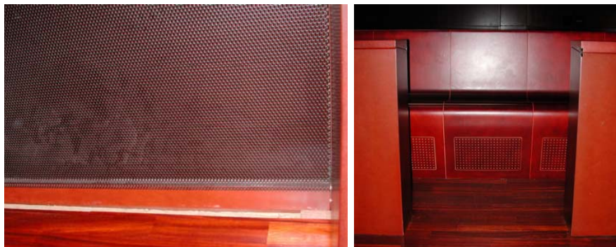
Figure 38. Soufflage de l'air sous les sièges des salles d'audience
