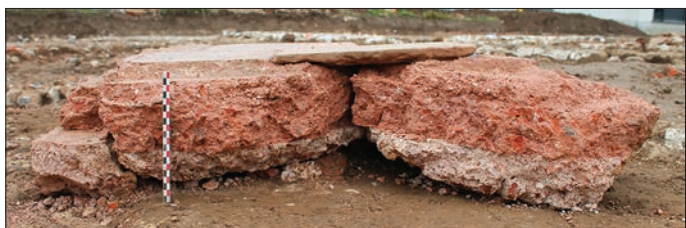
Fig. 17 – Vue de détail des couches de mortiers du fragment de suspensura découvert dans les comblements de l'hypocauste 2131 (cliché : D. Labarre).
