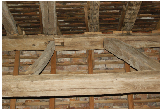
Figure 96 : La réparation du sous-faîtage avec l'assemblage de deux pièces avec un tenon
