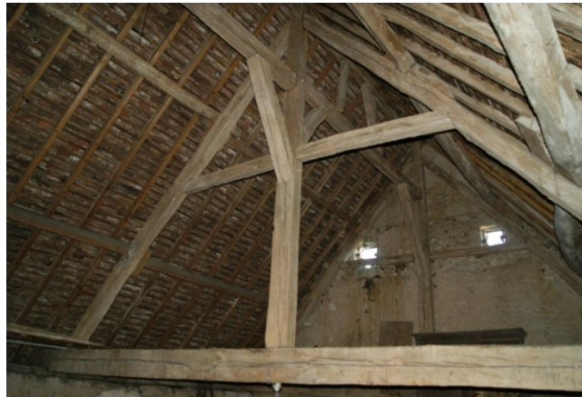
Figure 21 : vue du niveau 3 du bâtiment 2, charpente (fermes 65 et 64) et mur pignon 101, avec les ouvertures 60 et 61
