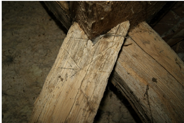
Figure 100 : Détail des lignages préparatoires sur la jambe de force ajoutée à la ferme 67
