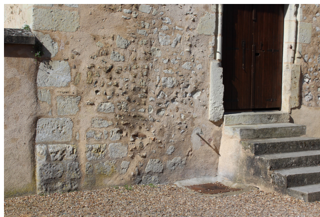
Figure 73 : Partie basse du mur 106 (UC 141) correspondant à un possible mur de terrasse
