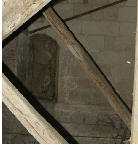
Figure 66 : Face intérieure de la fenêtre 19 avec une arrière-voissure en arc surbaissé ; traces de peintures ou négatif de bois oblique à droite
