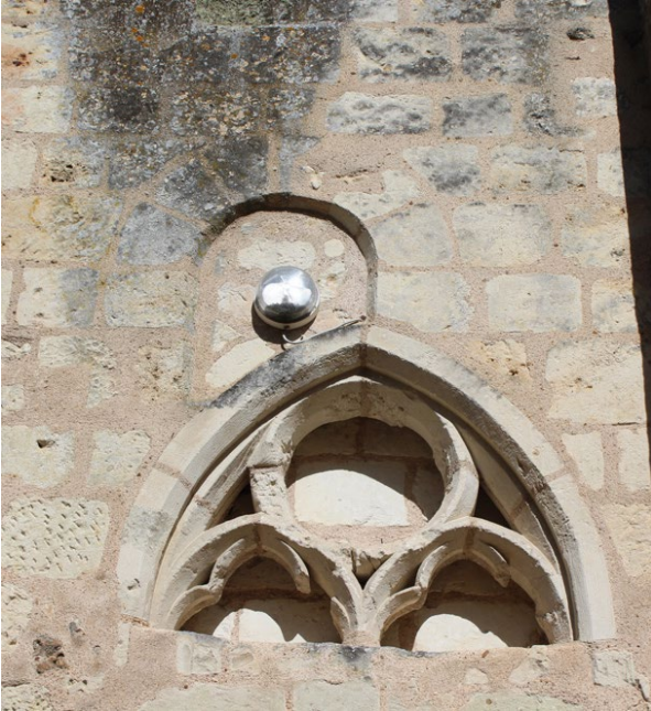
Figure 35 : Face extérieure de la baie en lancette 36 (phase 1), perturbée par la fenêtre à remplages 35 phase 3) (mur 103, bâtiment 2 niveau 2)
