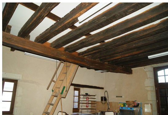
Figure 97 : Plafond 83 avec les traces d'encastrement d'une cloison dans le sommier (bâtiment 3 niveau 2)
