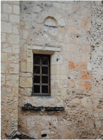
Figure 77 : Vue d'ensemble de la fenêtre 37, remplaçant la baie 38 et la fenêtre 94 (bâtiment 2, niveau 2)
