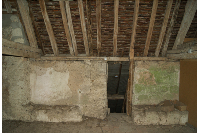
Figure 40 : Partie supérieure du mur 102, avec le ressaut de maçonnerie à 1,2 m du sommet (phase 1), perturbé par la création de la porte 68 et de la cheminée 45 (phase 5).
