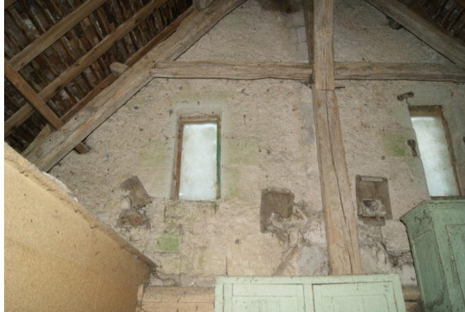
Figure 62 : vue intérieure du pignon sud-est du bâtiment 2 (mur 103) avec les ouvertures 71 et 72
