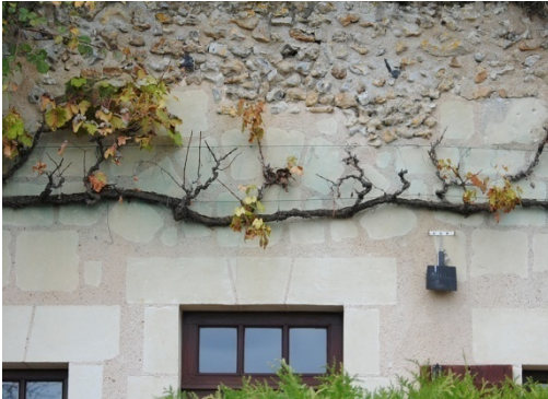
Figure 146 : Arc dans le mur de façade d'un troglodyte, chemin des Tombelles (Troo)
