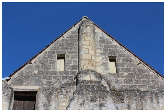
Figure 27 : Détail de la souche de cheminée cylindrique CHE 73 (phase 1) intégrée dans le pignon (phase 3)
