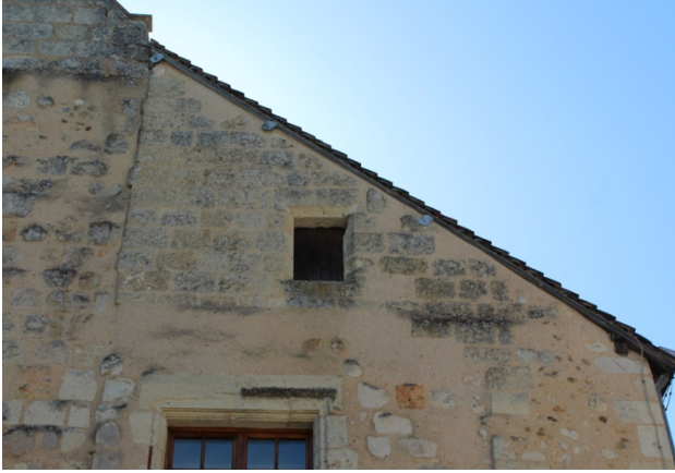
Figure 65 : Détail du pignon nord-ouest construit lors de la phase 3 avec la fenêtre chanfreinée 19 (bâtiment 1)
