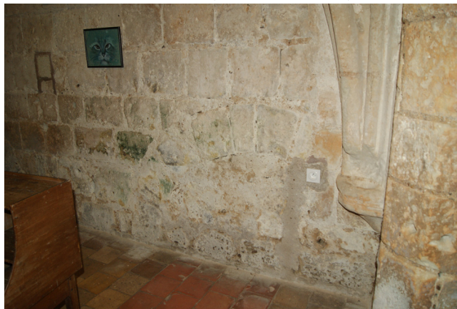
Figure 34 : Arc de décharge 32 dans le mur 102 (bâtiment 2, niveau 1)
