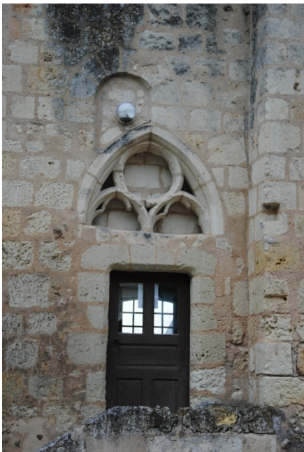
Figure 57 : Baie 36, perturbée par la fenêtre 35, elle-même remplacée par la porte 34 (bâtiment 2, niveau 2)
