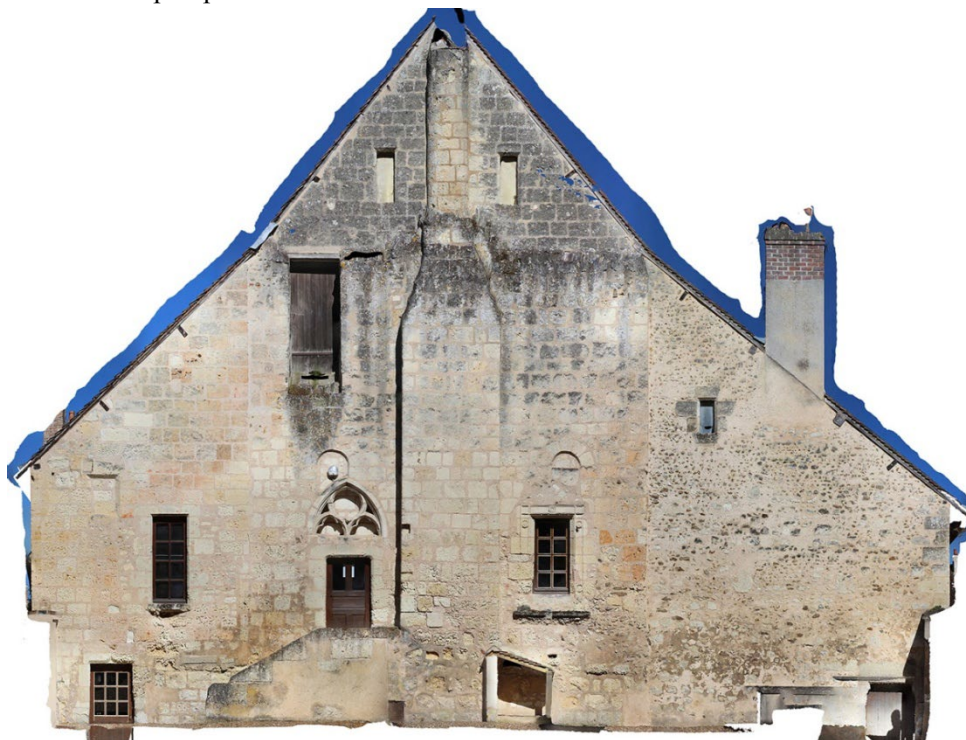
Figure 12 : Orthophotographie de la façade sud-est des bâtiments, réalisée par photogrammétrie (E. Marot)
