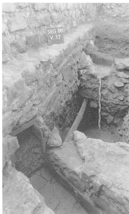
A gauche, Fig. 23 — Egout de la Voie II : regard R3 avec sa dalle de couverture en molasse.
