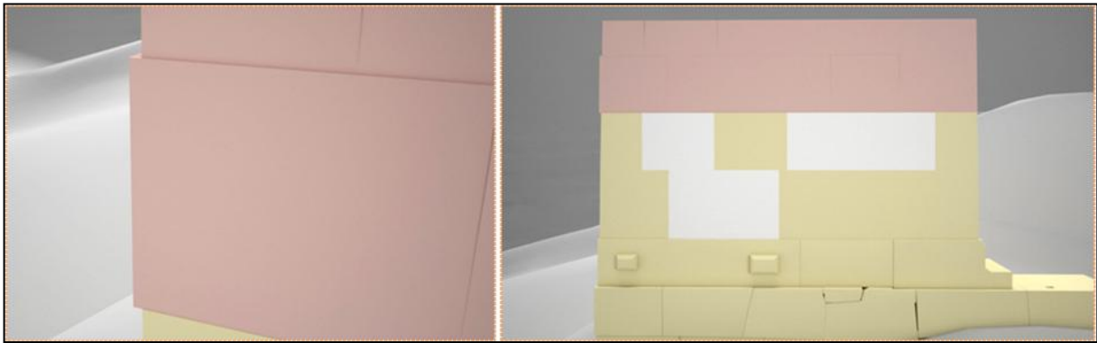
Figure 12 : La façade Est du British Museum présente un dépassement de plusieurs centimètres entre le lit d'attente de l'Assise A 1 et le lit de pose de F1.
