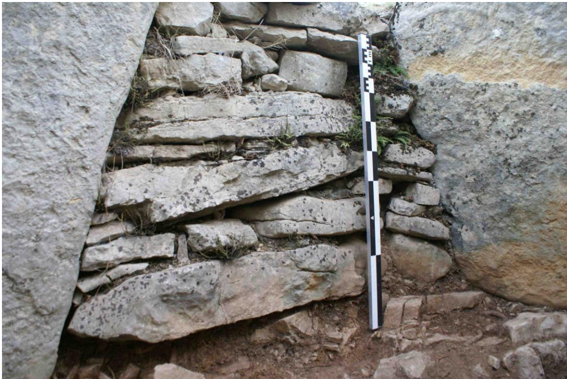
Figure 196 : Détail du Mur 1 dans le prolongement de l'orthostat sud-est. A droite de l'échelle est visible un empilement de dalles comblant les interstices avec la dalle d'entrée.
