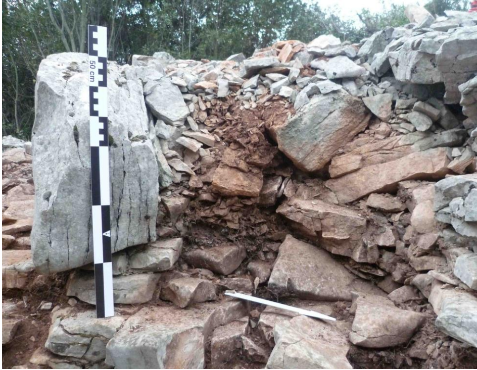
Figure 68 : Mur de retour (MR2) très érodé de la chambre (depuis le nord-est)
