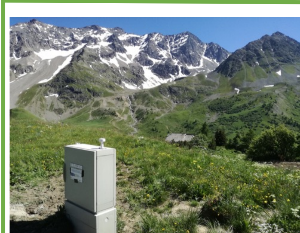
OGSA Col du Lautaret (05) Juillet 2018 220VAC – Réseau UGA
