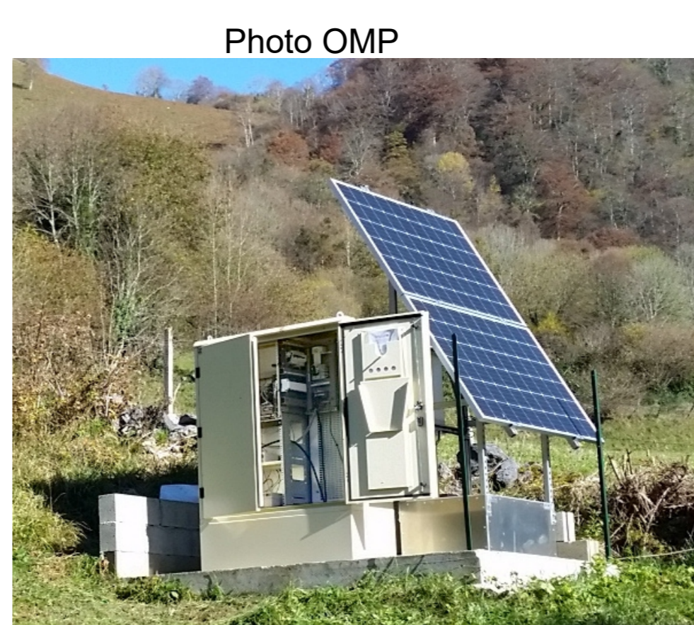
Station du Castet (REYF) dans les Pyrénées (infrastructure solaire Bleu Ciel Energie).
