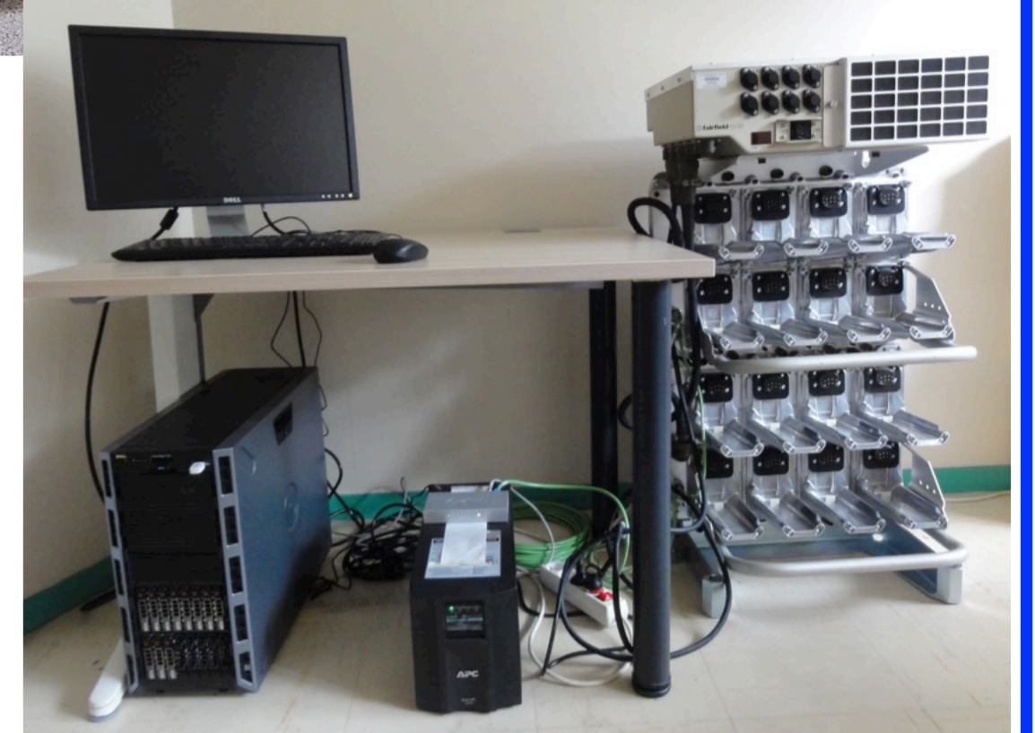
Serveur et rack: configuration, recharge batteries et déchargement des données
