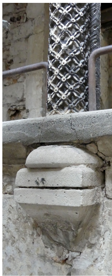
La colonnette 1060 de la coursive du troisième étage. Détail de la base prise dans la main courante cimentée du garde-corps.
