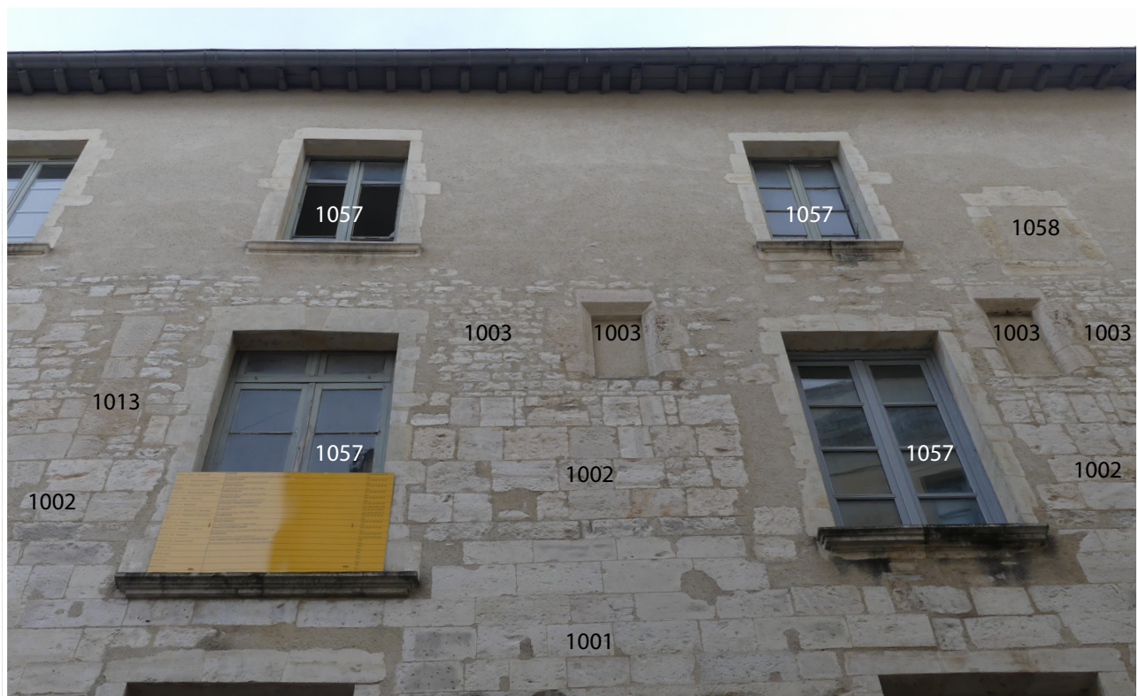
Fig. 23 Les surélévations successives de la façade sur rue MR1001, US 1002 puis US 1003, avec les ouvertures associées à la seconde. Cl. O. Maufras/Inrap
