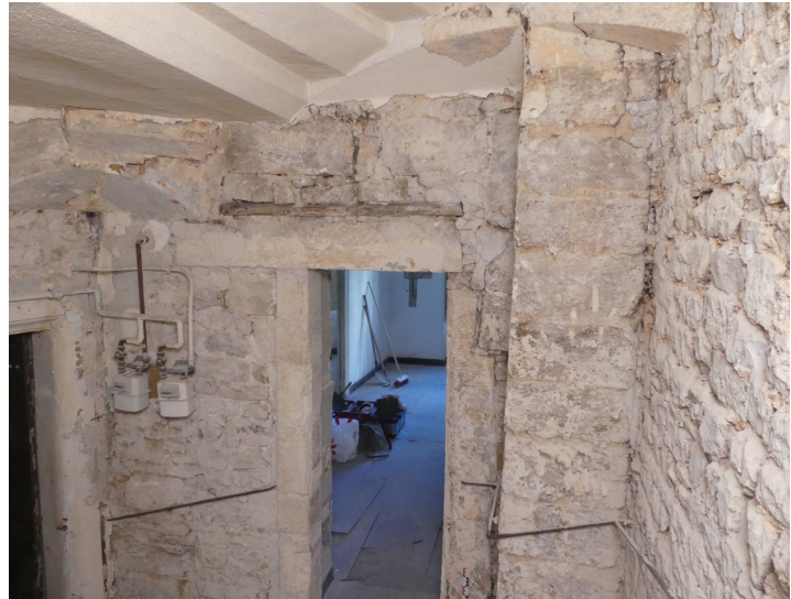
Fig. 30 Vestiges du premier escalier en vis dans les angles de la cage. Ici le mur de façade méridionale MR1007 du corps de logis principal au premier étage avec sous les marches de l'escalier postérieur ES1034, les consoles de support des degrés du premier escalier. On note à gauche la porte 1049 donnant sur la loggia et à droite la porte 1046/1047 dans son dernier état. Cl. O. Mauftras/Inrap.
