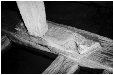
Fig. 7 - Assemblage d'about de l'entrait retroussé de la ferme de croupe réemployé en semelle en 1708.
