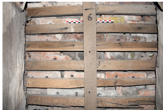
Fig. 8 Transept nord, versant ouest (sondage 6) : tuiles médiévales sans crochet parfaitement identifiables en sous-face de la couverture (cl. S. Aumard).
