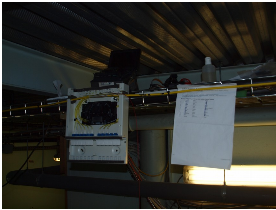
Figure 10: Boîtier de raccordement posé à quelques centimètres d'un câble 400V, avec 3 tubes sur les fibres d'un tube de 6 fibres coupés à 2 m à droite du boîtier, puis extraits du câble
