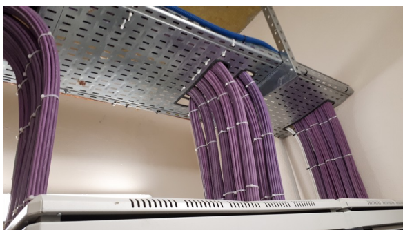
Figure 5: Un des sous-répartiteurs en cuivre à l'Institut Néel – 450 terminaisons RJ45
