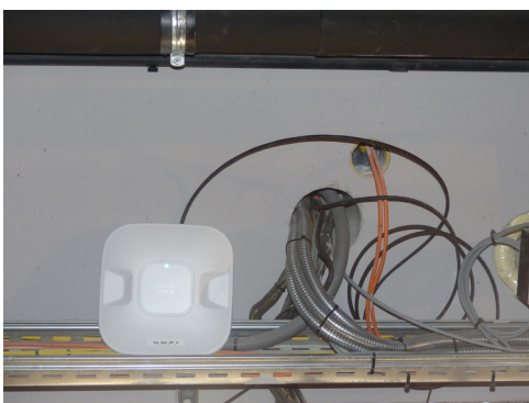
Figure 3: Borne Wi-Fi connectée directement sur le port interne du micro-commutateur le plus proche
