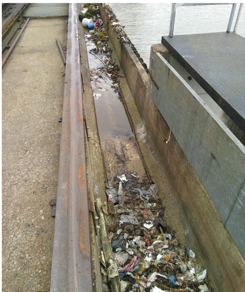
Photo 5 : Canal d'évacuation des déchets dégrillés. Beaucoup de films plastiques. Mars 2019
