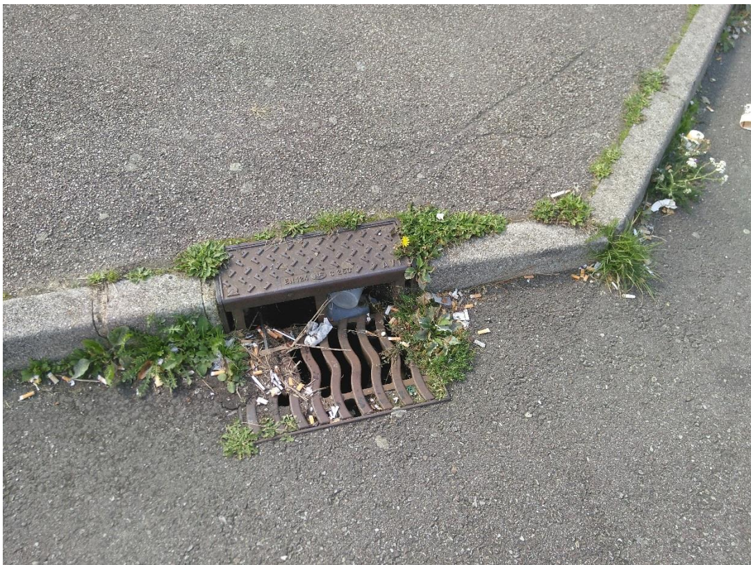
Photo 2 : Berges d'Alfortville en octobre 2018 (à gauche), de Port Mort en avril 2019 (à droite) ; des déchets sur un avaloir d'aire d'autoroute en septembre 2018 (A13, aire nord de Bosquet). Présence de déchets remobilisables dans l'eau le long des berges mais aussi hors de l'eau sur les berges, lorsque le niveau d'eau augmente.
