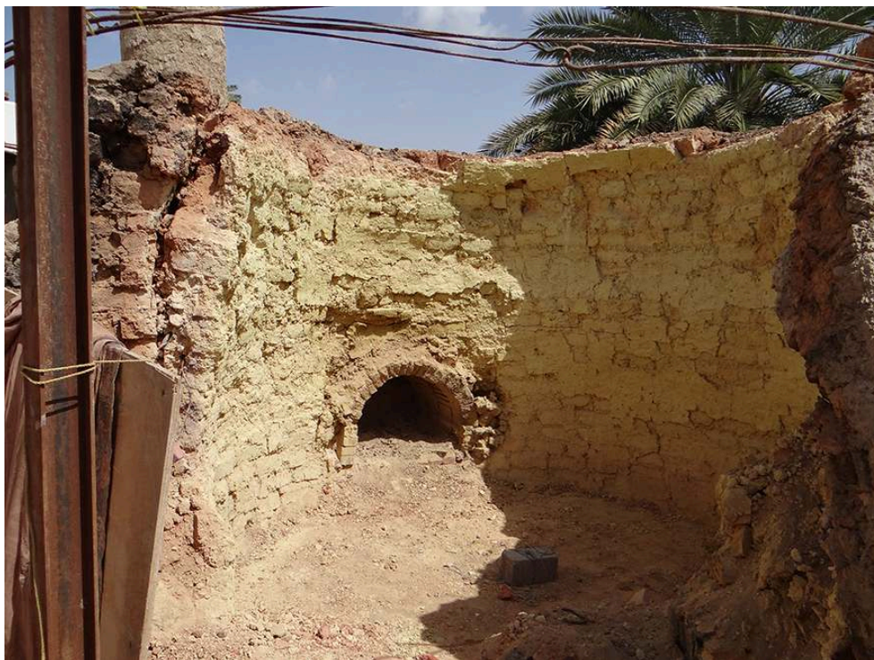
Figure 9 – Nouveau four circulaire endommagé.
