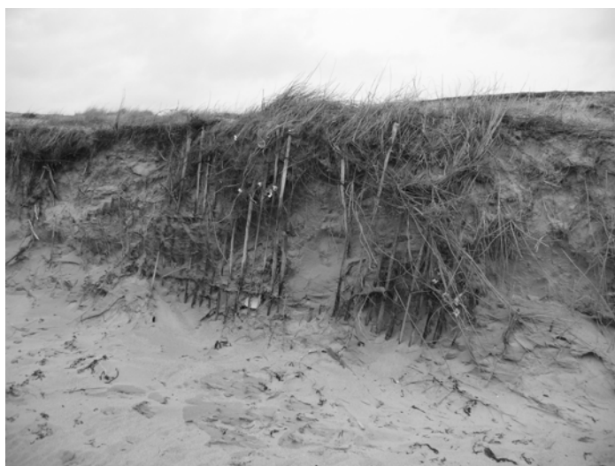
Figure 2: plage de Kerminthy, 13 Février 2007. Erosion de la dune, pente en profil concave. La barrière de ganivelle est fortement dégradée, et des encoches sont visibles sur le flanc de la dune.
