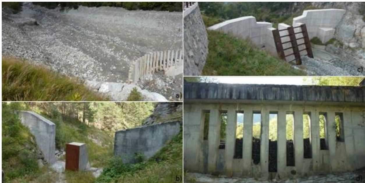
Figure 14 : Barrages filtrants : a) Barrage peigne de Rio Fosse (Val de Susa, It.) : rétention complète par blocage mécanique des galets ; b) Barrage à dent de Rio Joans (Val de Susa, It.) piégeage sélectif des gros blocs par blocage mécanique ; c) Barrage à fentes large équipées de grilles aciers du Torrent de Grand Valey (Val d'Aoste, It.) : rétention des événements extrêmes liée au colmatage des grilles par blocage mécanique de gros blocage et d) Barrage à pertuis du Lavanchon (Isère, Fr.) : modulation par contrôle hydraulique + rétention complète par blocage mécanique des flottants
