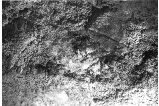
Fig. 22 – Signe de forme parabolique G (photo R. P.).
