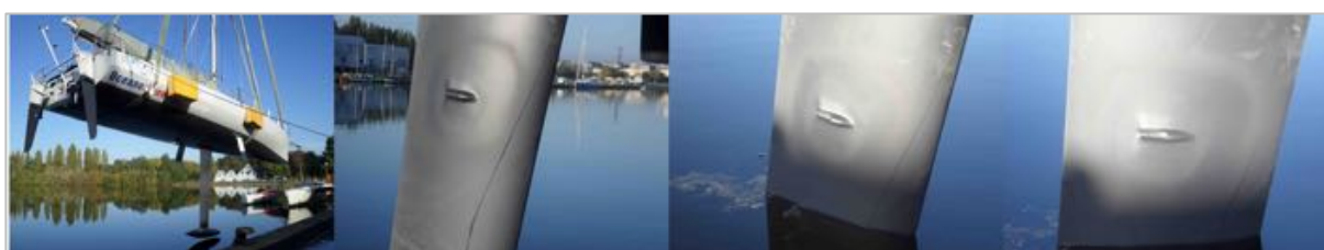
Figure 9 : Une sonde externe de température a été installée de part et d'autre de la quille - Ici à tribord
